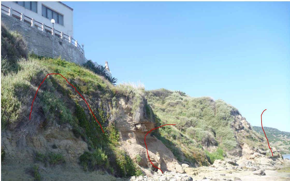
Foto 3: Smottamenti nel tratto compreso tra le sezioni A e 2.
