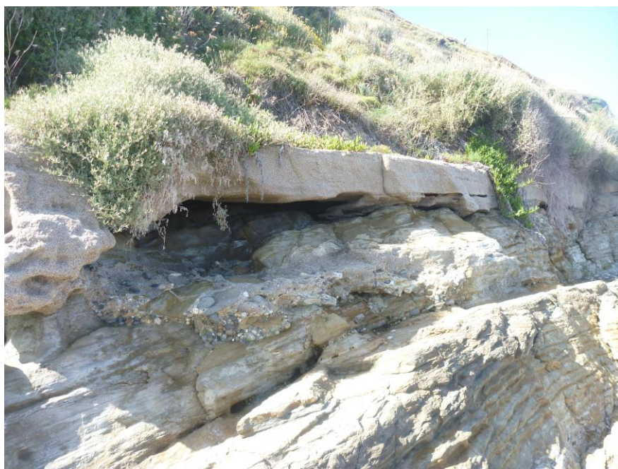
Foto 1: Sottoescavazione in corrispondenza del contatto tra il substrato litoide e la soprastante formazione sabbioso-arenacea.
